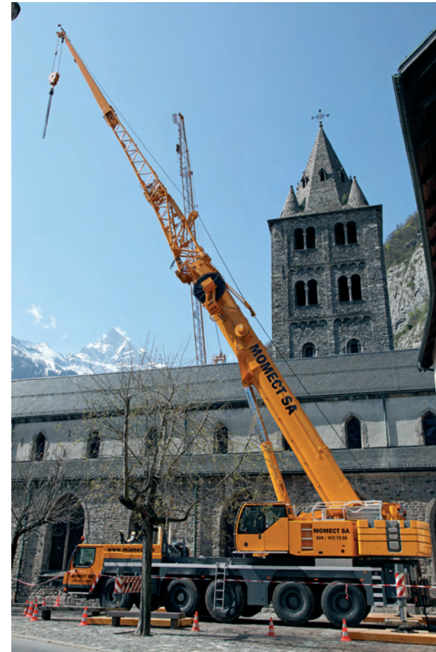
Après d'importants travaux dans la falaise, de puissantes grues ont mis en place les éléments de la couverture du Martolet.
